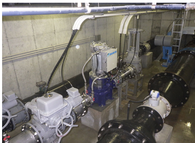
写真 5 マイクロ水力発電設備
