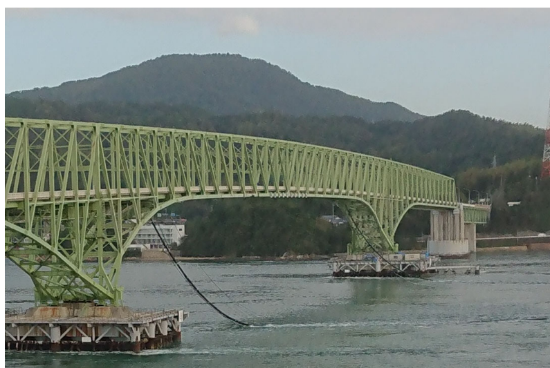
写真 1 平成 30 年 10 月 22 日 大島大橋添架送水管の脱落
